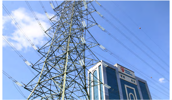
► Menara penghantaran bekalan elektrik Tenaga Nasional Berhad
